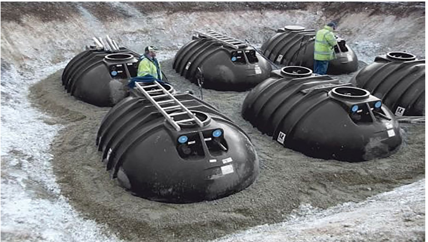
FOT. nr 36 – przykład zastosowania zbiorników podziemnych z tworzyw sztucznych (Źródło: https://www.ekspertbudowlany.pl/arttykul/woda-i-kanalizacja/189233.zbiorniki-do-gromadzenia-i-wykorzystania-wody-deszczowej )
